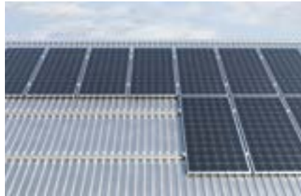
Dach mit Trapezblechdachsystemen
