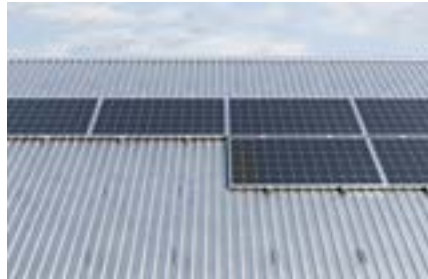
Dach mit Trapezblechdachsystemen
