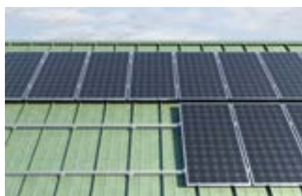
Steildach mit Stehfalz-Eindeckung
